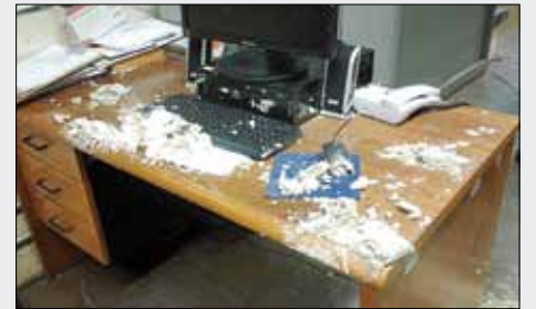
Parte do forro desaba no fórum das Execuções Fiscais – Pág. 06
