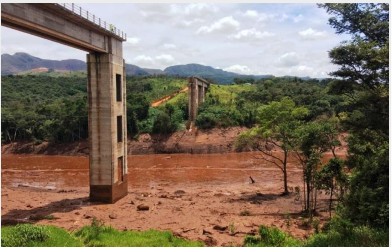
Ponte em Brumadinho após rompimento da barragem da Vale. (Foto: Guilherme Venaglia/Wikimedia)
